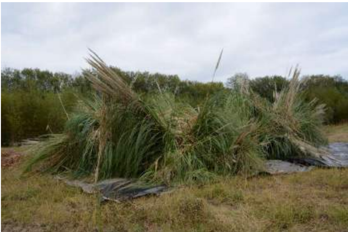
Apilado de Cortaderia selloana previo a su carga en camión y transporte a gestor de residuos.
