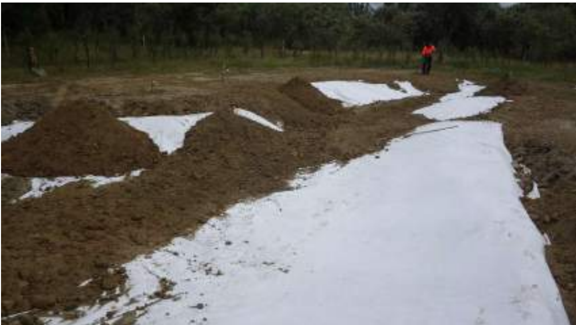
Trabajos de impermeabilización de los trabajos para la recuperación de la funcionalidad del espacio.
