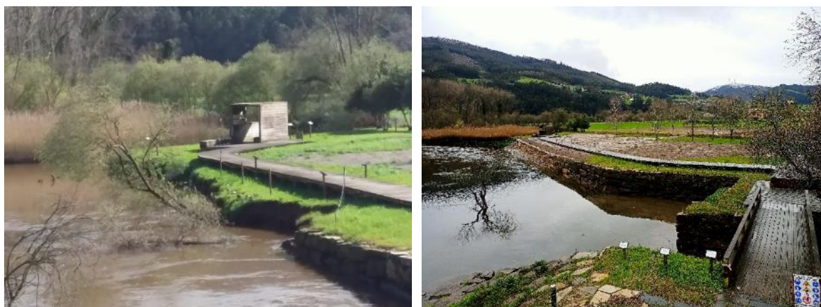
Figura 54. Fotos de campo tomadas en el marco de los trabajos de seguimiento del LIFE Fluvial en marzo de 2020 (izquierda) donde se puede ver el nuevo proceso erosivo y en diciembre de 2020 (derecha) donde se puede ver la ampliación de la escollera.
