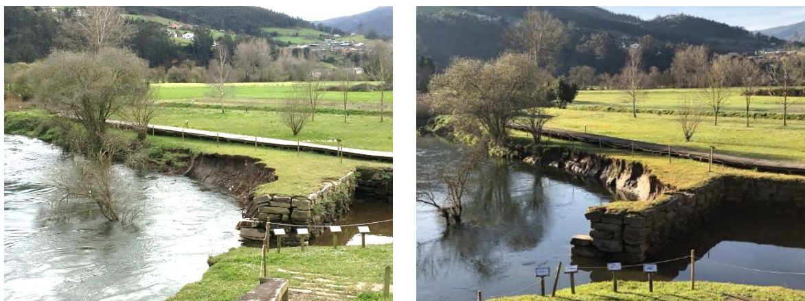
Figura 52. Fotos de campo tomadas en marzo de 2018 (izquierda) y febrero de 2019 (derecha) donde se puede ver el importante avance del proceso erosivo en menos de un año.
