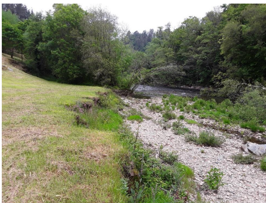
Figura 3. Vista del tramo de ribera sometido a procesos erosivos.
