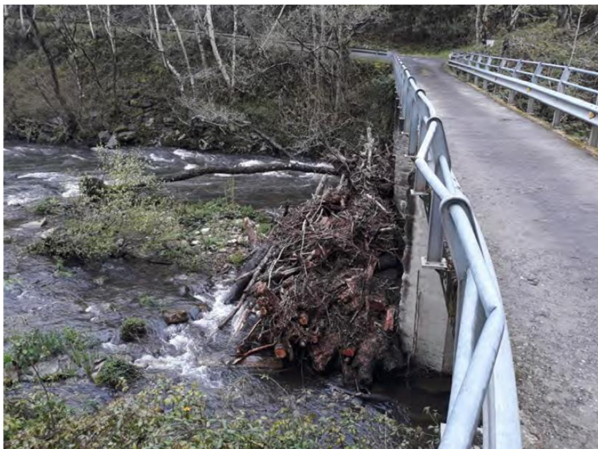
Figura 7. Retención de troncos y ramas en el puente sobre el Eo aguas abajo del enclave de Fondón.
